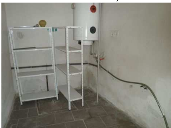
zdroj teplé vody
