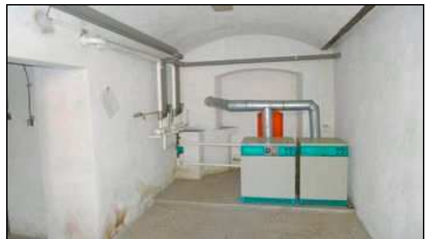
sklep - plynová kotelna
