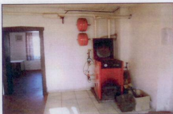
Kotel ÚT (přízemí)
