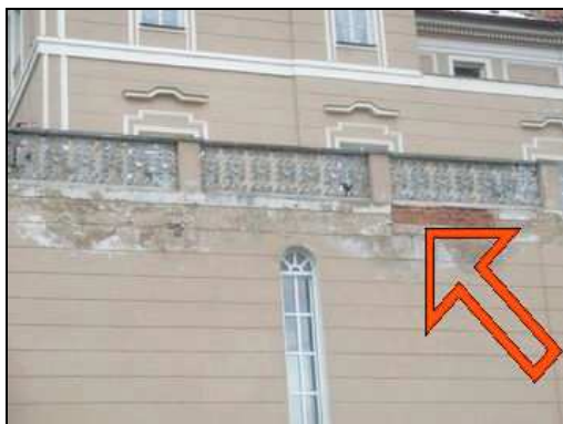
poškození u terasy
