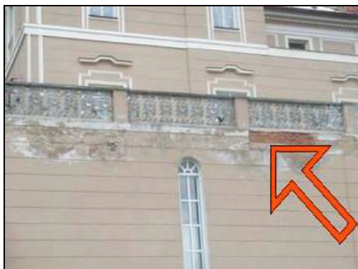
poškození u terasy
